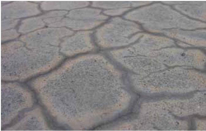
Rissbildung im Beton
