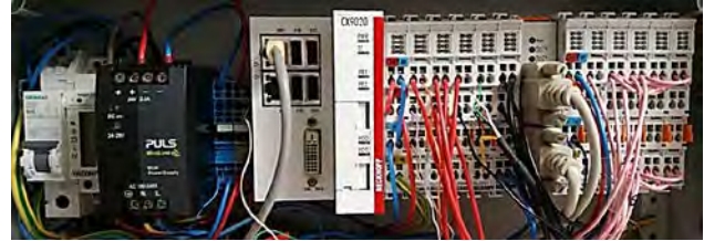
Bild 11: SPS Schaltschrank mit 24V Netzteil
